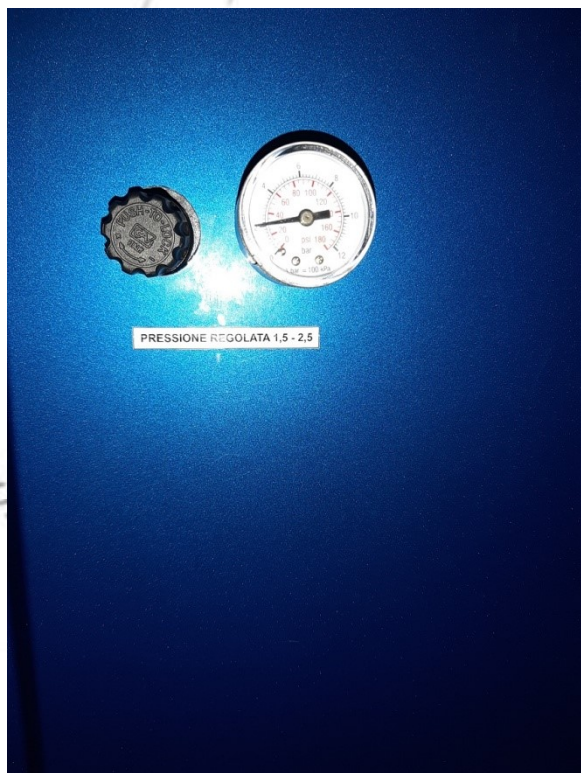
Manometro e regolatore pressione (posizionato sul lato posteriore del banco)
