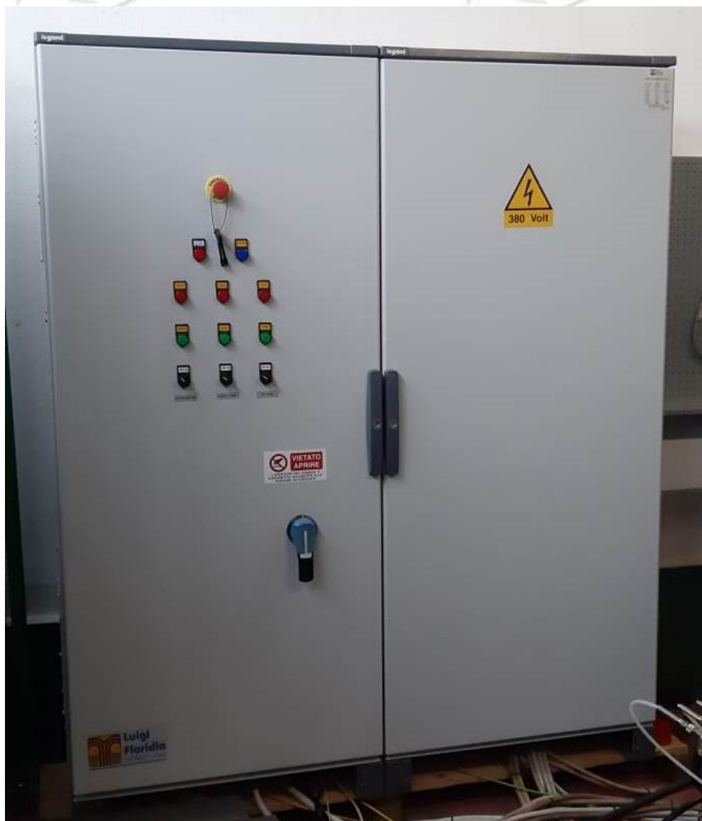
Cabina quadro elettrico generale (per la versione 110 KW)
